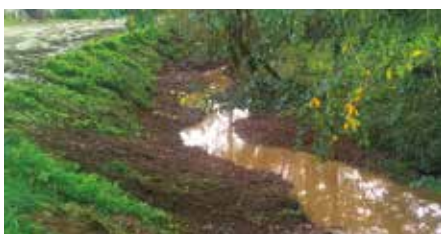
Octobre 2022 : apport de cailloux dans le lit pour le resserrer et ainsi améliorer l'écoulement, limiter l'érosion.
