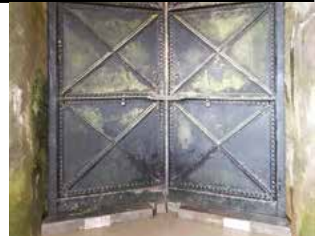
On compte 26 portes à crues sur le Pays d'Ancenis.
